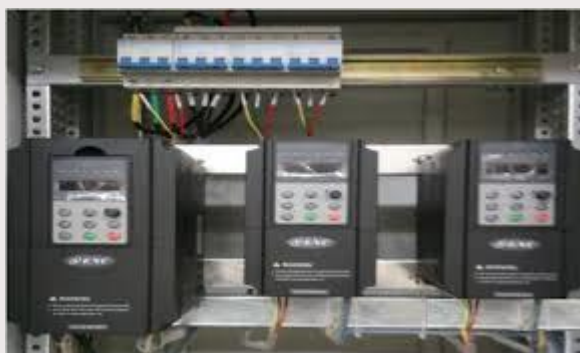
電氣室/變頻器室
