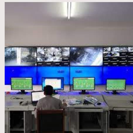
控制室/控制系統磁片櫃室
